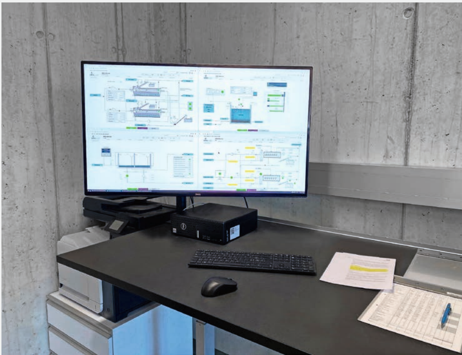
Fig. 4 Bedienstation für das PLS ARAbella in der ARA Brienz – komfortabel und übersichtlich auf einem Bildschirm dargestellt. Dank der lizenzfreien Webtechnologie ist der Kunde unlimited an Anwenderstellen auf dem gesamten Gelände.
