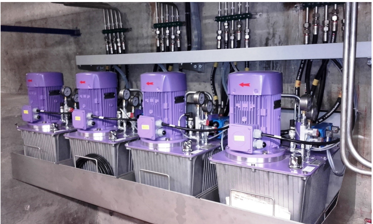
Figure 7: Installation hydraulique pour plusieurs dégrilleurs
