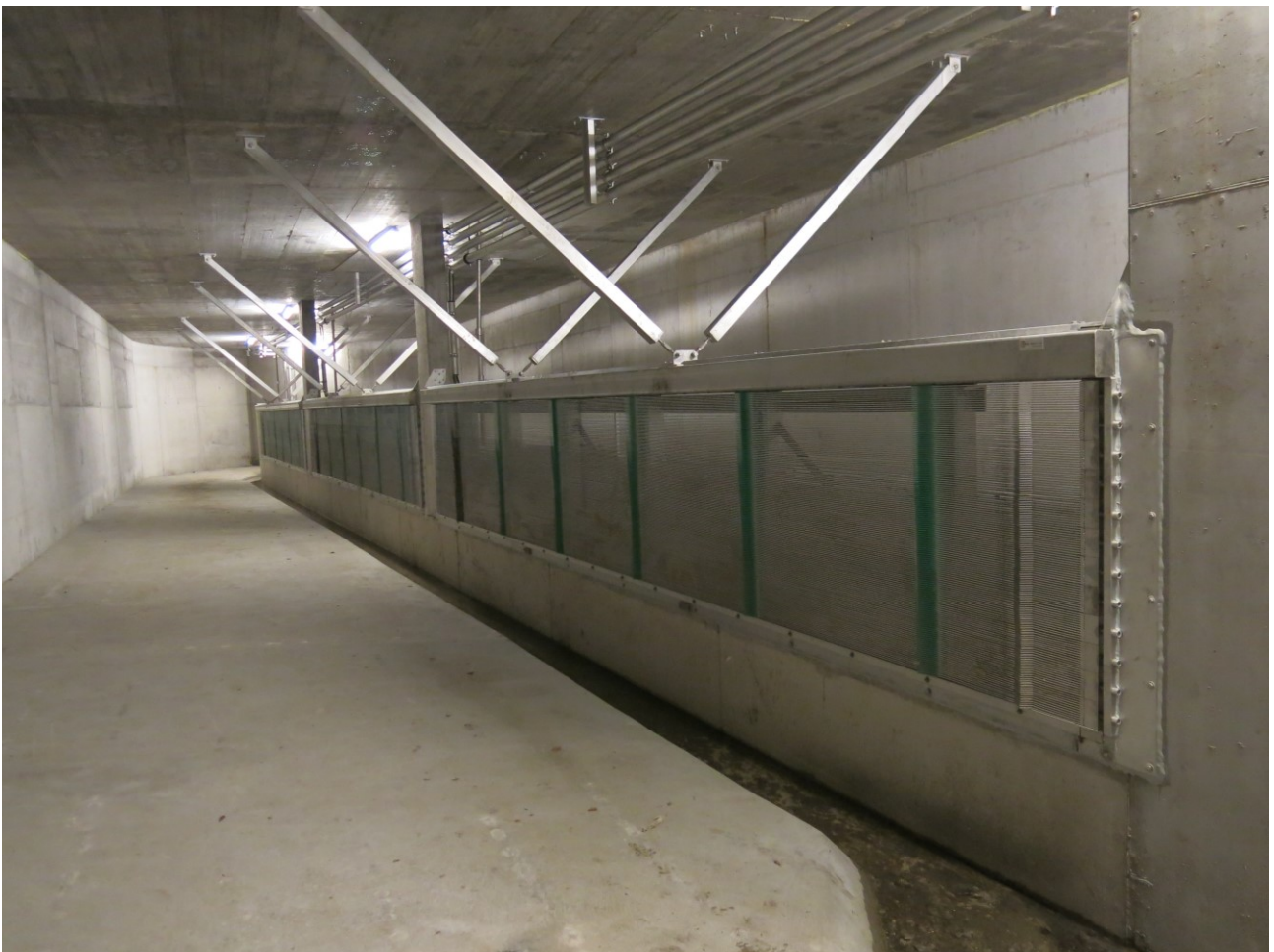
Figure 1 : Dégrilleur hydraulique vertical
