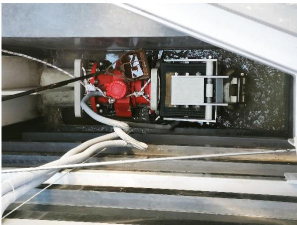
Figure 1-3 Puits d'étranglement avec PNA, intégrés dans l'espace confiné.
