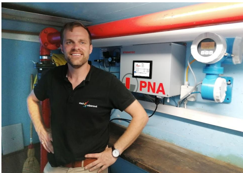
Figure 2 ; Fritz Seewer, chef de projet du bureau de génie civil de la ville de Wädenswil, devant la nouvelle commande de l'un de ses régulateurs de débit PNA piloté par MID
