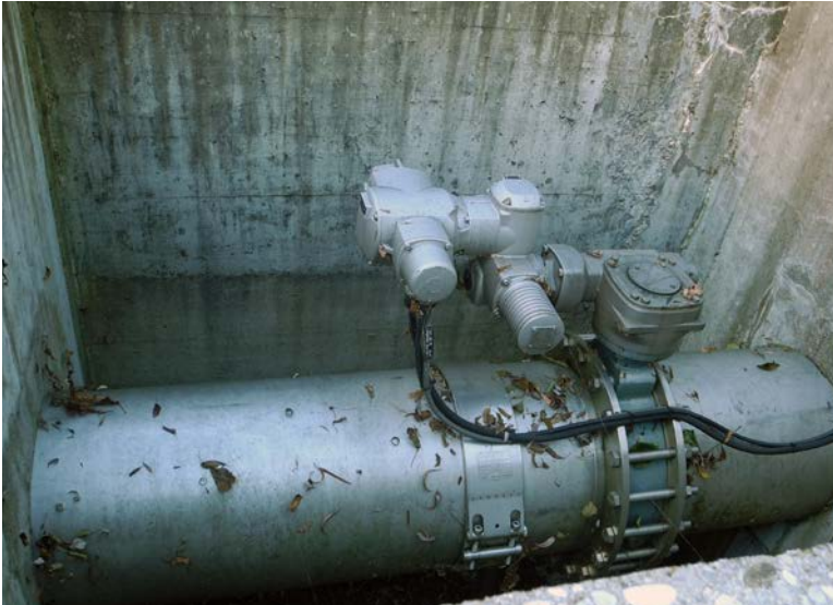
Régulation d'écoulement précédente avec vanne de régulation
