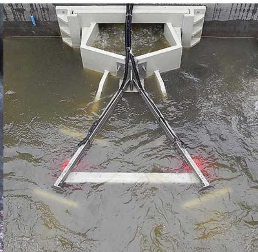
Installation de mesure du flux d'arrivée en service
