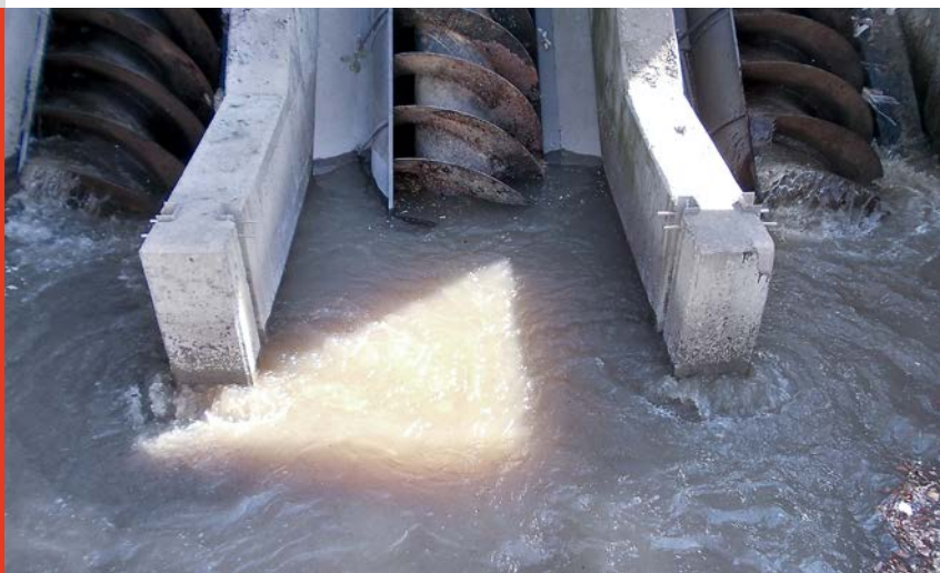
Dispositif de levage canal d'arrivée avant
