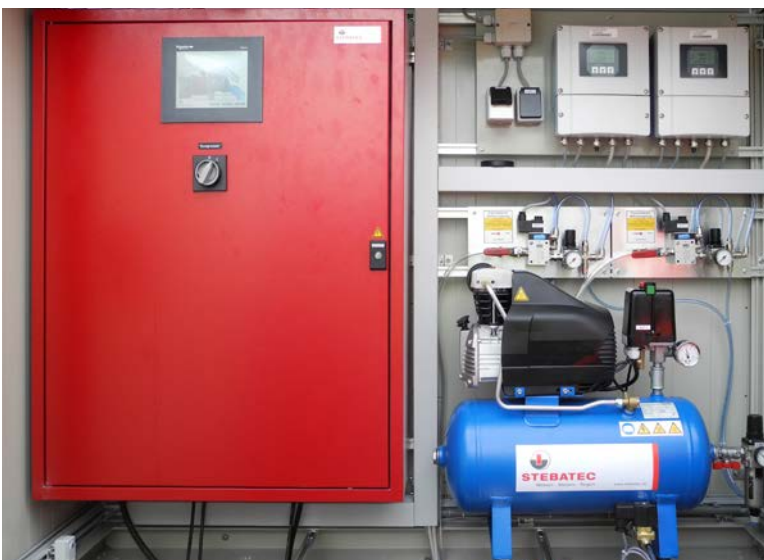
Armoire de commande
