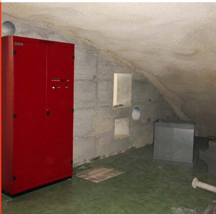
Une des nombreuses armoires de commande locale.
