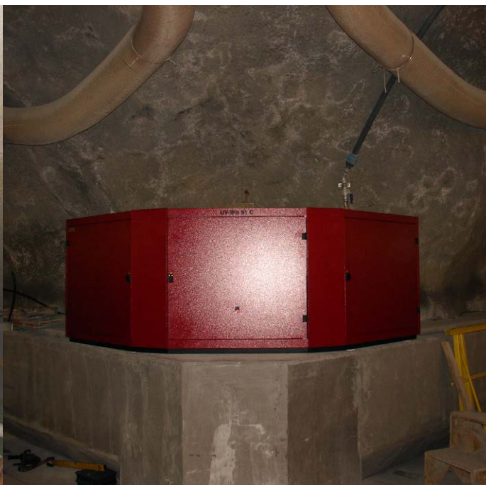
En raison d'encombrement nous avons fabriqués une armoire sur mesure. Elle a été placée dans une branche Y dans la caverne.
