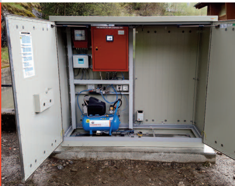
Vue dans la cabine, avec l'armoire de commande de la régulation pneumatique du débit à remplissage partiel du BEP de Galgenbühl.
