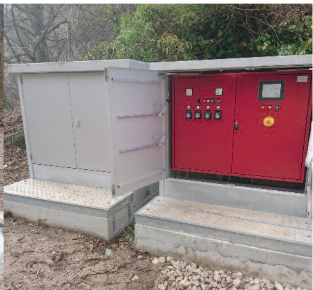
Le groupe hydraulique et l'armoire électrique sont montés dans des cabines en béton et parfaitement protégés.
