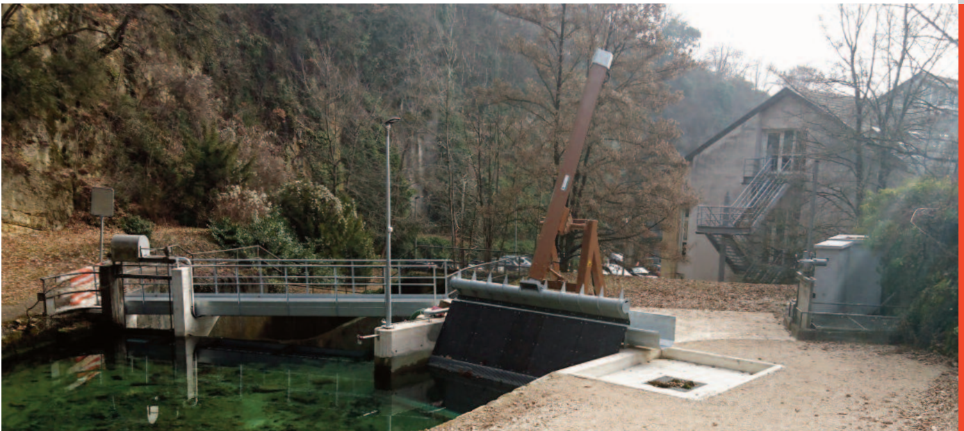
Vue d'ensemble de la nouvelle installation (de g. à dr.): Vanne de décharge, éclairage, machine de nettoyage de la grille avec champ de grille, conduite de purge et cuve en béton, vanne principale et cabines en béton abritant le groupe hydraulique et l'armoire électrique.
