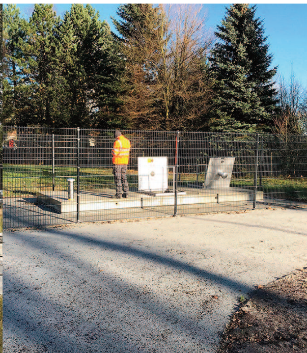
Le regard terminé avec clôture et trappes d'accès ouvertes pour les travaux d'entretien et les contrôles.
