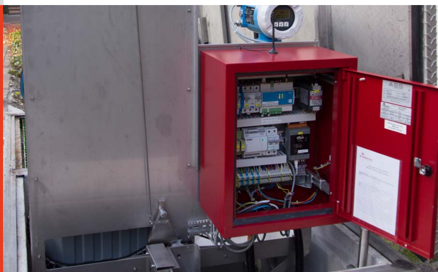
Le libre accès à l'armoire de commande est dorénavant possible.
