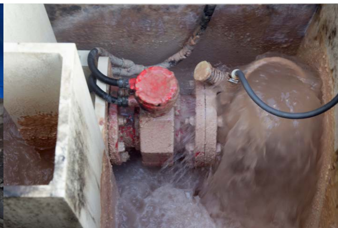
Les eaux usées passent dans la station de mesure de débit. Les échantillons prélevés arrivent dans le collecteur via le tuyau souple (à droite).
