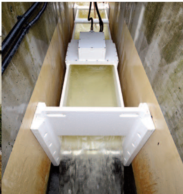
Le débit de la STEP de Radet est nouvellement relevé à l'aide d'un système de mesure de débit stationnaire dans des conduites partiellement remplies.
