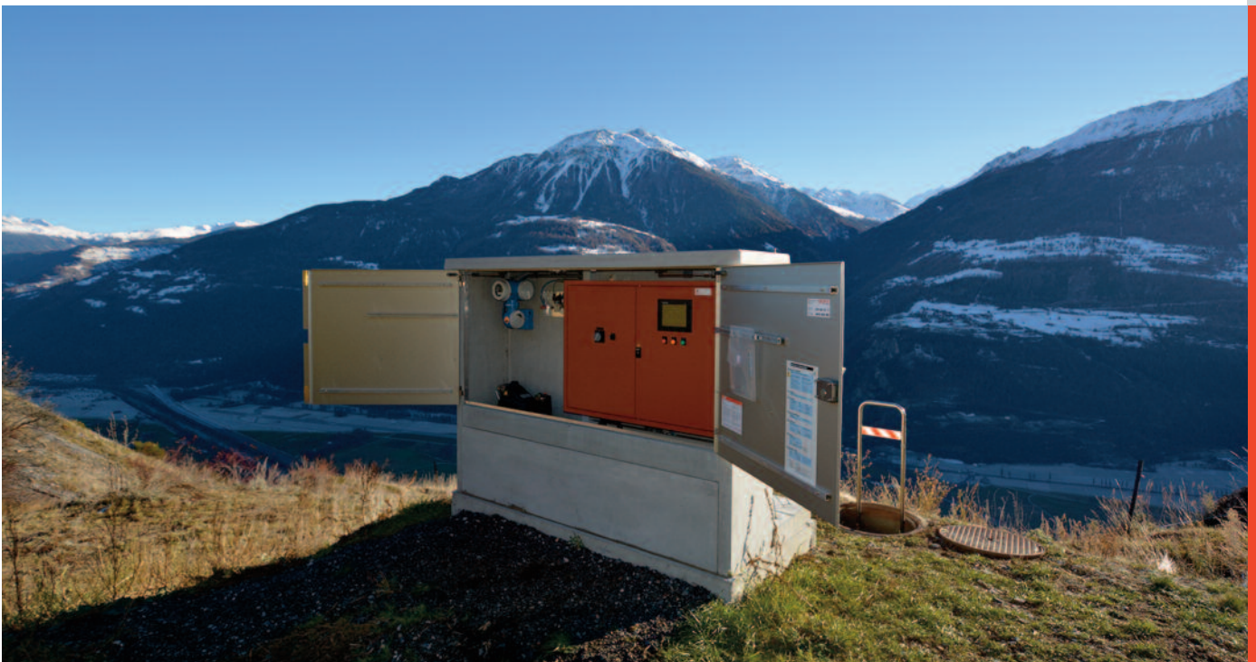
L'armoire de commande du bassin des eaux pluviales d'Erschmatt (commune de Loèche) est situé en montagne, loin au-dessus de la vallée principale.
