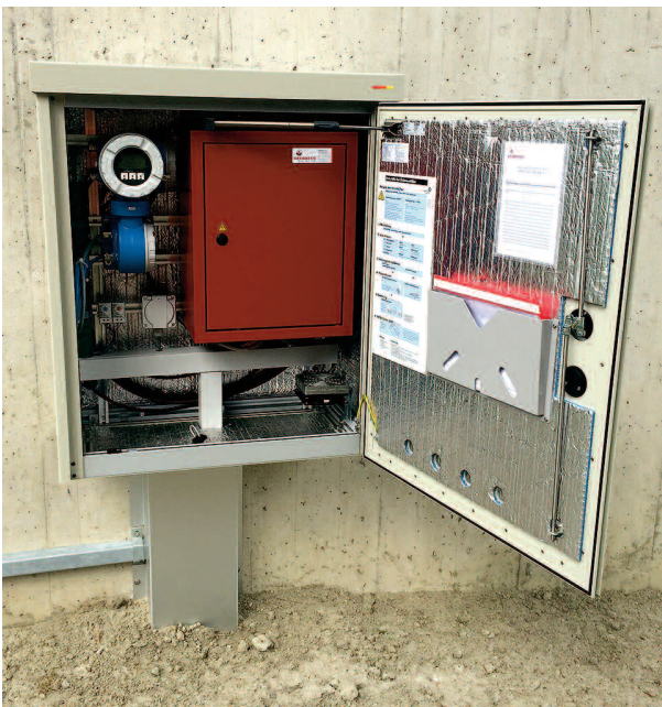
Vue dans l'armoire de commande de la station de mesure de Raron.
