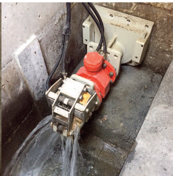
Station de mesure d'Eischoll: Régulation de débit avec commande MID.
