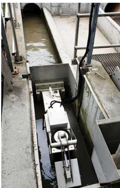
Figure 1 : Régulateur d'entrée installé
