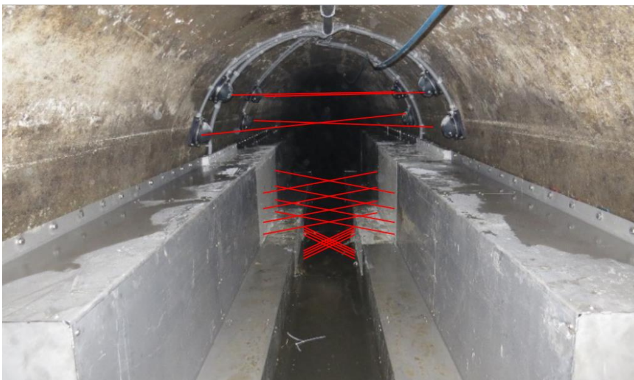
Figures 2 + 3: Mesure de débit dans l'égout de stockage DN 2000 avec gouttière pour temps sec insérée pour la grande plage de mesure de 50 – 2'000 l/s. Sur l'image de dessous, les sections de mesure par ultrasons sont représentées par des lignes rouges.
