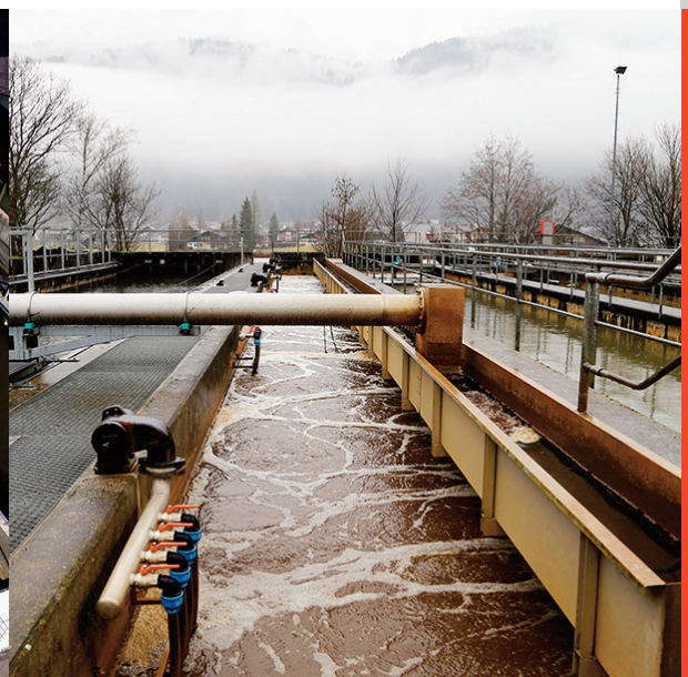
Blick in eines der Biologiebecken.
