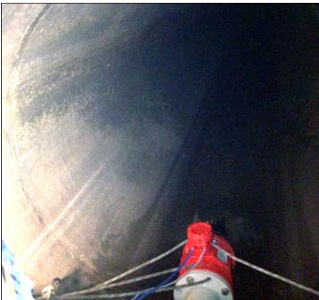
Wangen, Aufbahrungshalle – DN 150
