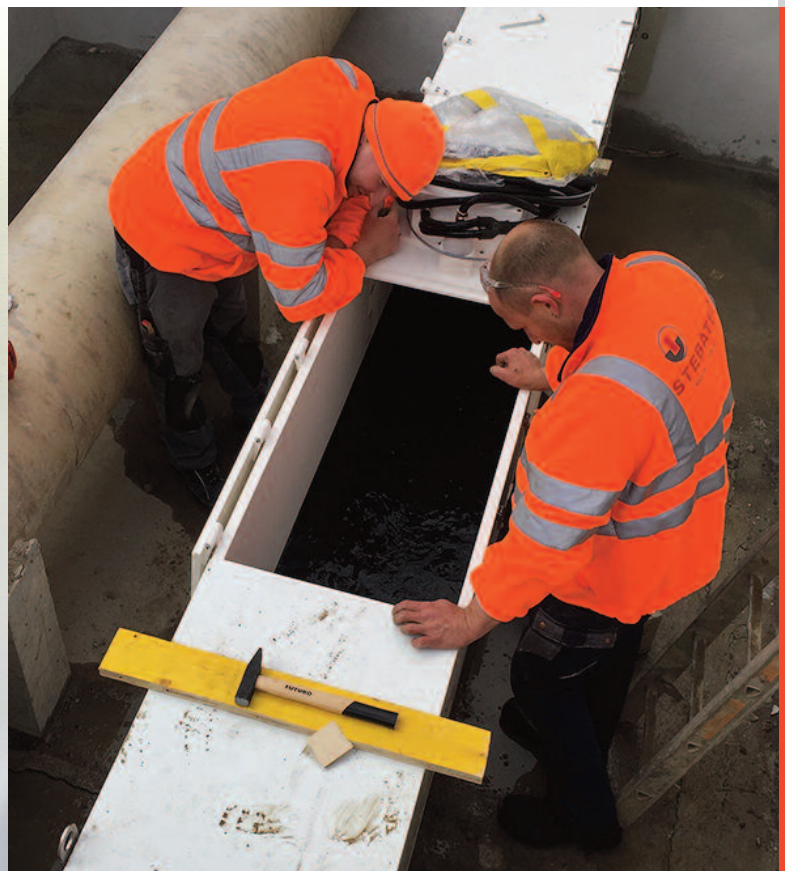
Grosse und komfortabel angeordnete Wartungsluken bieten bei Inspektionen und Wartungsarbeiten eine fast uneingeschränkte Zugänglichkeit.
