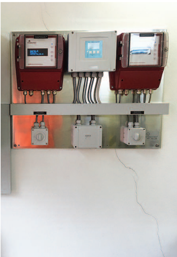
Die Messwertumformer leiten die Daten an das Prozessleitsystem und optional per GPRS an ein externes Wartungsunternehmen weiter.
