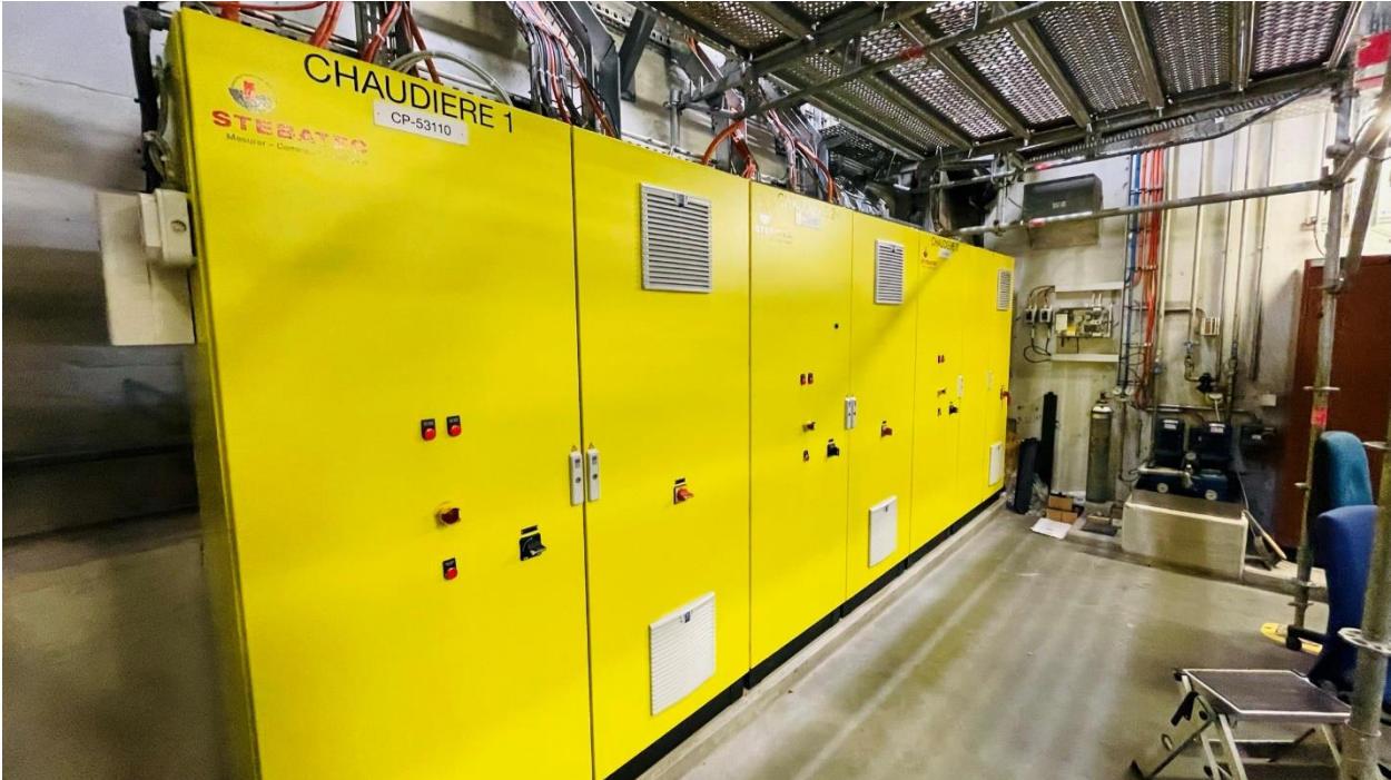
Abbildung 4: Schaltschränke mit integrierter Steuerung
