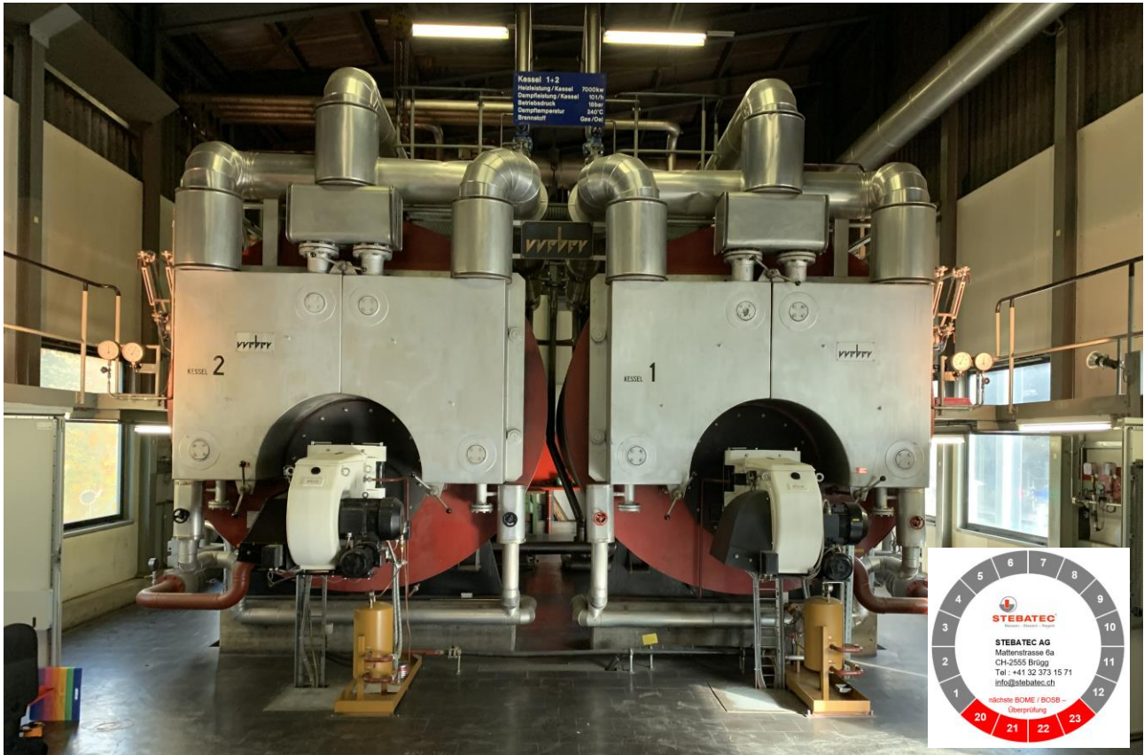
Abbildung 1: Dampfkessel als Bestandteil der Zug-Reinigungsanlage
